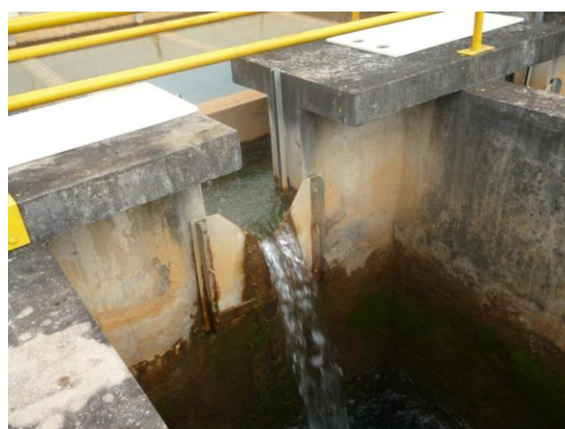
Foto 4.8 - Entrada dos Filtros
