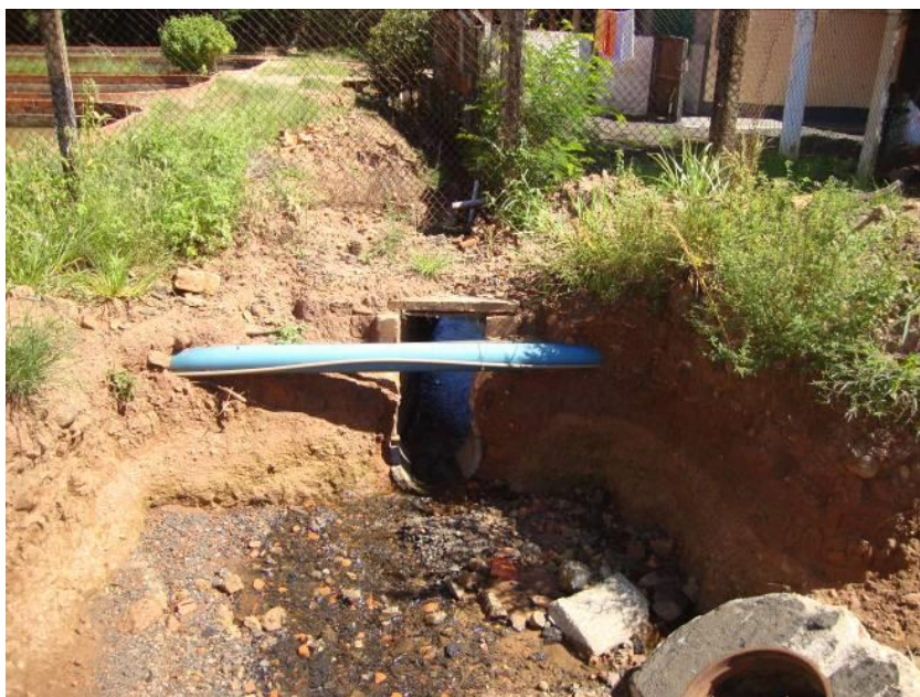
Foto 4.23 – Erosão no Bairro São João
